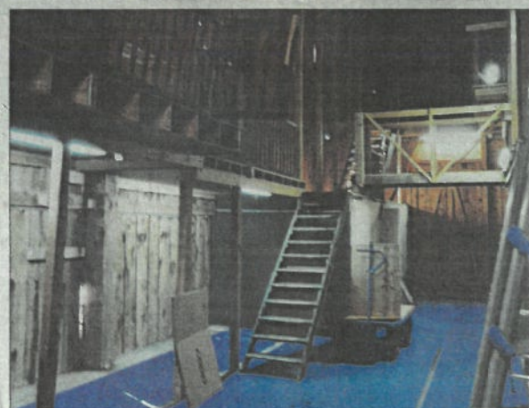
L'arrière-scène a dû être désamiantée
